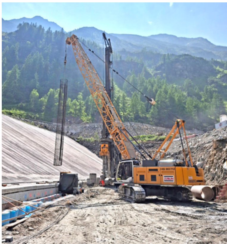
Als Servicegerät übernahm der Liebherr HS 8070.1 Seilbagger unter anderem das Einheben der Bewehrungskörbe.
